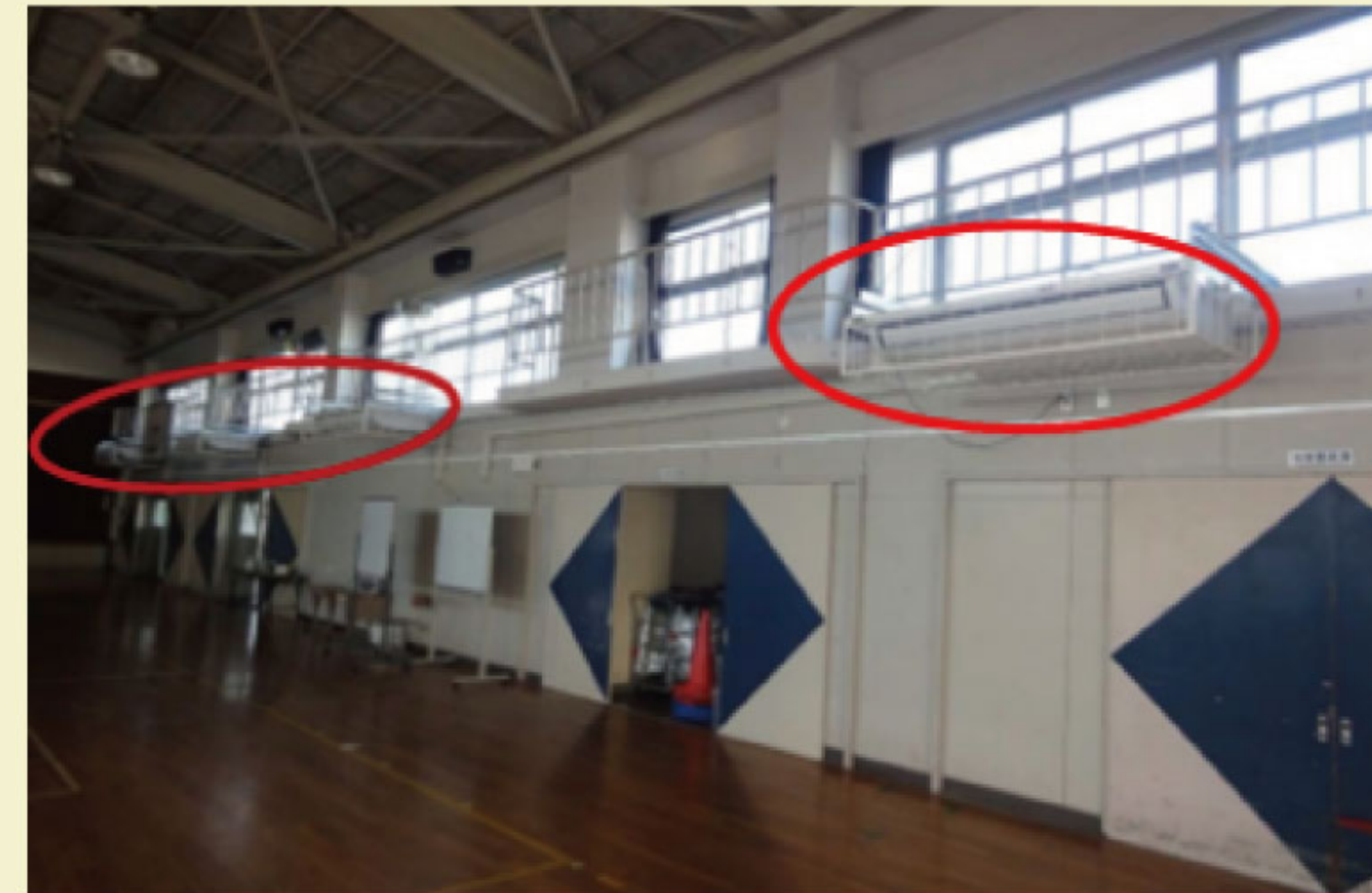
※写真は2023年度に県立特別支援学校体育館に設置した例
